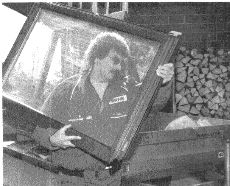
Neue Fenster: kleiner Schritt für den Handwerker, grosser Gewinn für Wohnkomfort und Heizkosten-Abrechnung.
